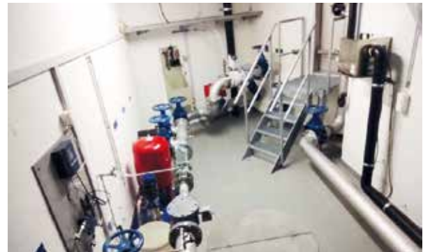
Heutiger Stand der Technik im Wasserreservoir
